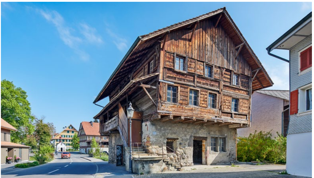
Die Alte Schmitte in Richensee ist einsturzgefährdet. Eine Sanierung ist dringend notwendig. Foto: Daniela Burkart
